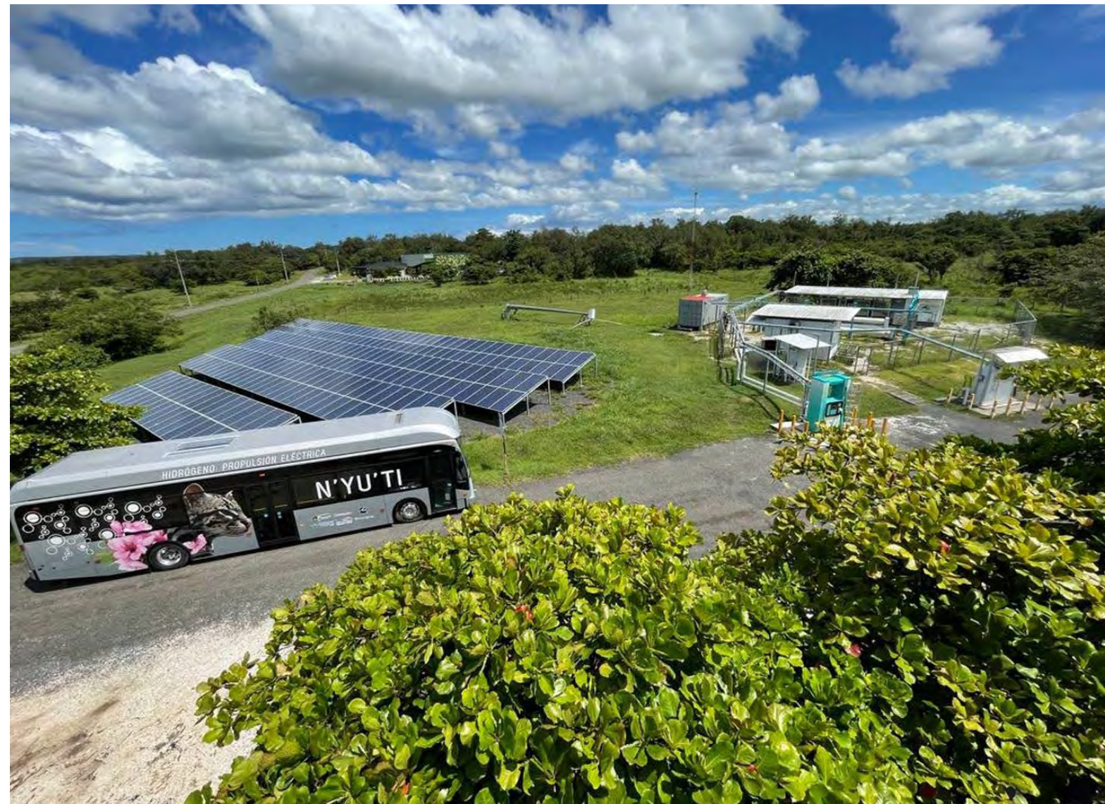
Los paneles solares alimentan el proceso de electrólisis para la producción de hidrógeno en instalación de Ad Astra, en Liberia. En la estación color verde se pueden cargar el tanque del autobús, traído en el 2017. Fotografía: Cortesía.
